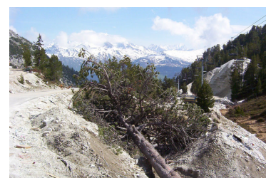
Terrassement sans gestion des talus
